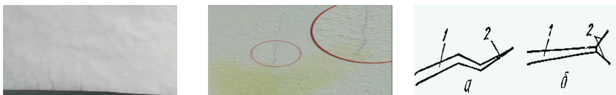
Рисунок 3. Развитие трещин в штукатурном покрытии при эксплуатационных воздействиях
